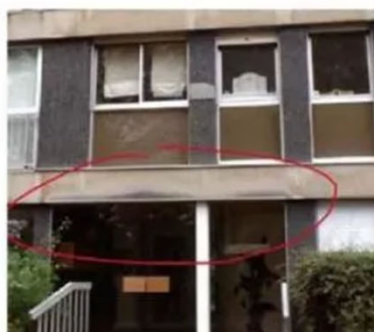
② Salissures projection l'eau pluviale
